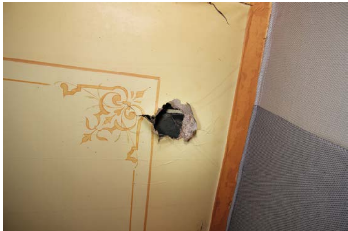
Detail van het spanplafond in nummer 59, dat op veel plekken niet meer te restaureren was. Er voor in de plaats kwamen met de hand vervaardigde replica's. Foto: Hans van Dam/Stichting Diogenes Leiden.
